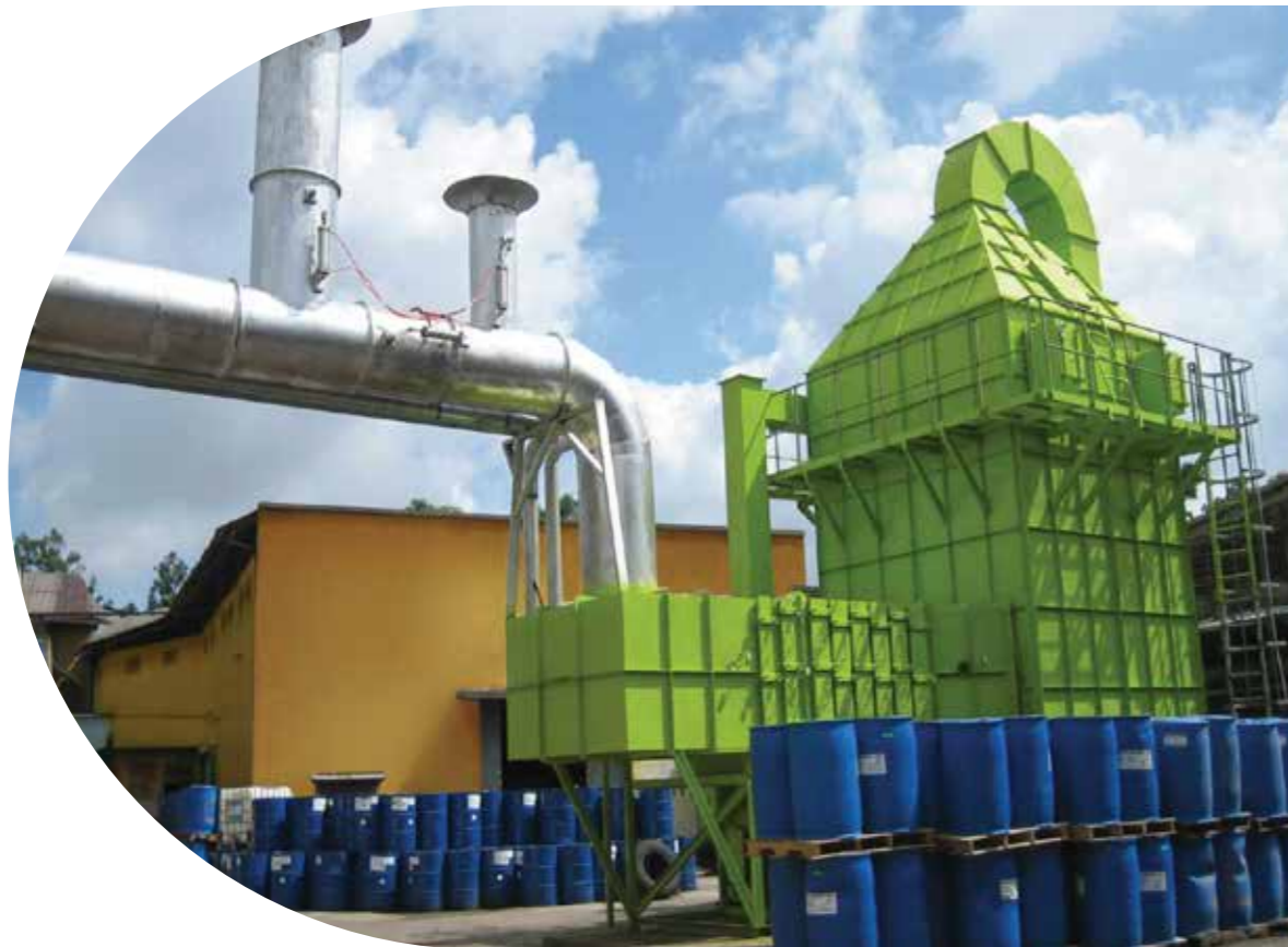
Hệ thống thu hồi khí thải DOP tại nhà máy sản xuất giả da PVC xốp.
